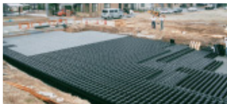
富山県内400m 2 級(地上部は公園に利用)
