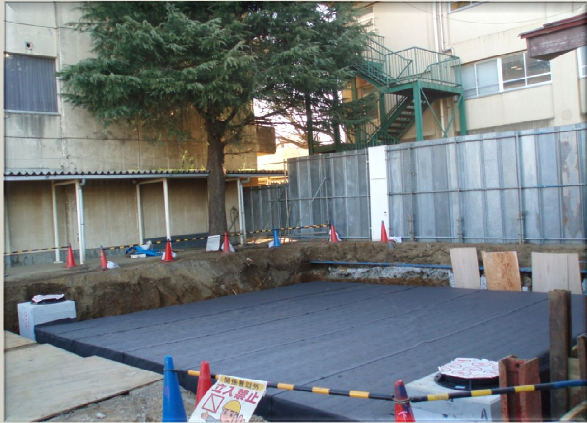
佐倉市立志津中学校調整池② クロスウェーブ(浸透タイプ) 106m 3
