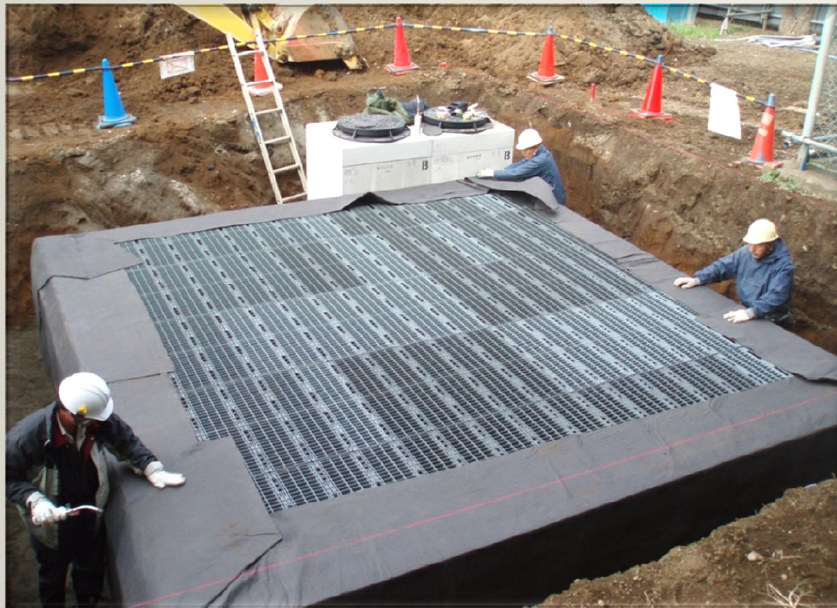
佐倉市立志津中学校調整池① クロスウェーブ(浸透タイプ) 24m 3
